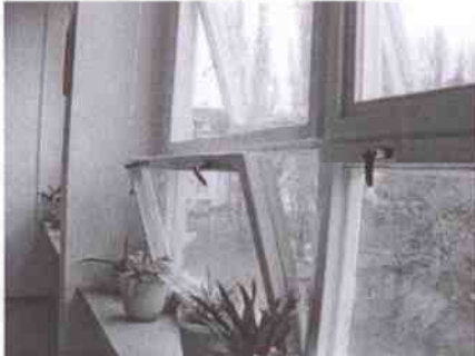
Zbytečné větrání v učebně č.21
