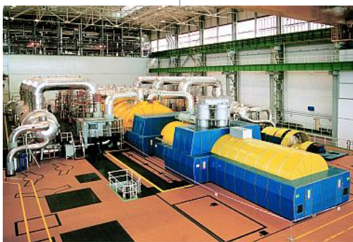
JE Temelín bude v případě schválení energetické koncepce posílena o nové bloky. Foto: ČEZ
