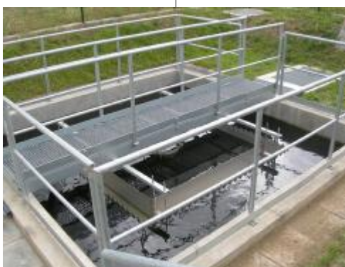
VAK Jižní Čechy (od 1. 5. 2010 transformovaná společnost ČEVAK) provozuje i tuto pouze rok starou mechanicko-biologickou ČOV v Olešnici na Česko-budějovicku.
