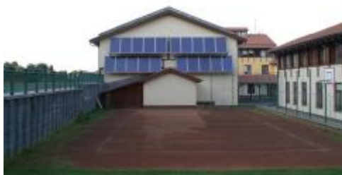
Velká instalace solárního systému pro ohřev teplé vody se dokončuje na ZŠ Lukavec na Pelhřimovsku, kde je i kombinace s tepelnými čerpadly pro vytápění. Foto: Regulus
