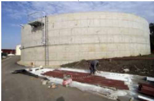
Celý komplex v obci Kněžice na Nymbursku se skládá z bioplynové stanice s kogenerační jednotkou, z výtopny na spalování slámy a dřevního odpadu a z teplovodního rozvodu tepla z předizolovaného potrubí v celé vesnici.
