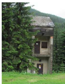
Dosloužívní trafostanice na dolní stanici lanovky.
