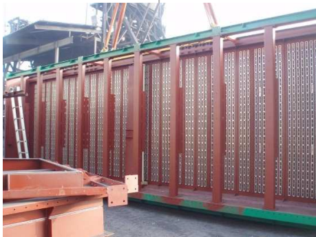
Filtrací jednotka s tkaninovými filtry byla namontována před výdech spaliny do komína.
