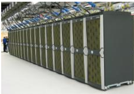
Jeden z nejrychlejších počítačů světa drží rekord i v rychlosti své instalace a uvedení do provozu.
