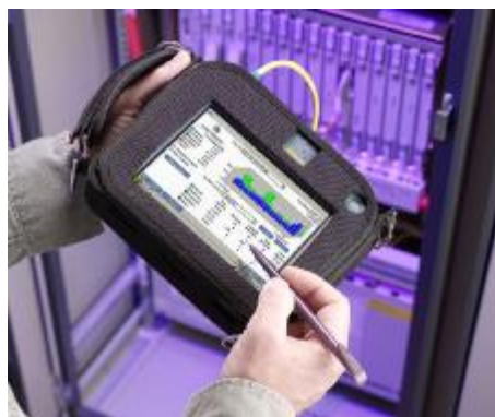
Přísný kontrolor sítí: MetroScope Service Provider Assistant pro detailní diagnostiku.
