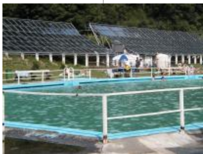
U koupaliště v Rusavě je nainstalován patrně největší solární systém v ČR. Foto: archiv
