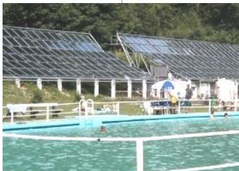
Solární systém na koupališti v Rusavě
