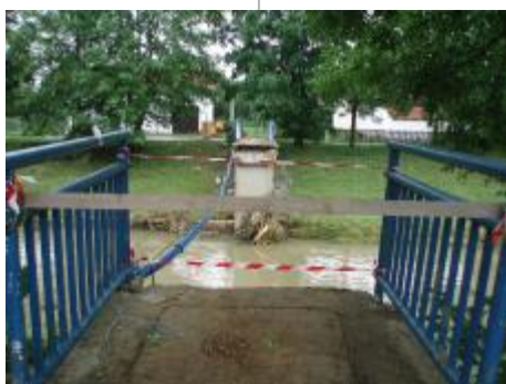
V Kuníně při povodních »uplavala« i tato lávka.
